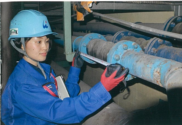
設備の更新に備え、管の寸法を確認する
